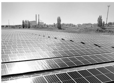
Установка собственной электростанции на базе солнечных панелей и получение сертификата ISO 14001
